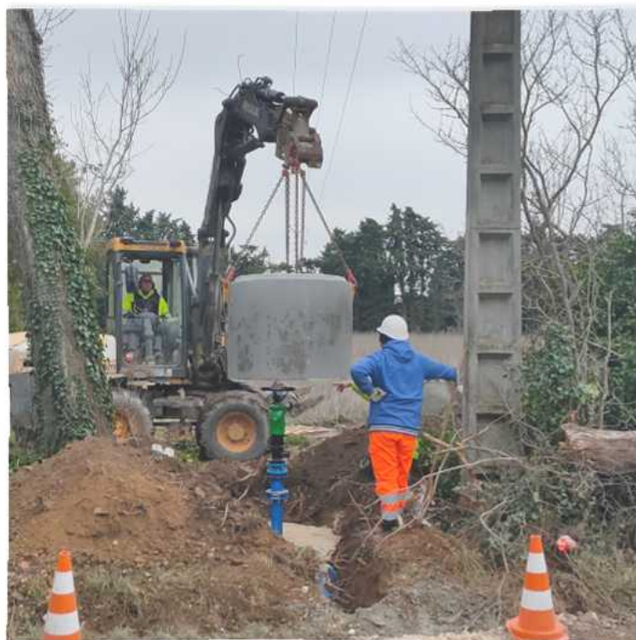
Pose de borne lors de modernisation sur le secteur de l'Isle. © Canal de l'Isle
