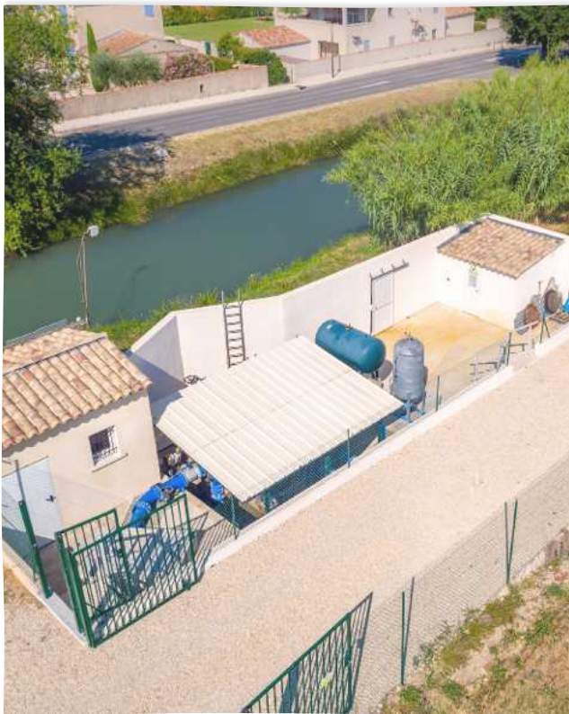
Station de Pompage Vidale du Canal de Cabedan Neuf © Canal du Cabedan Neuf
