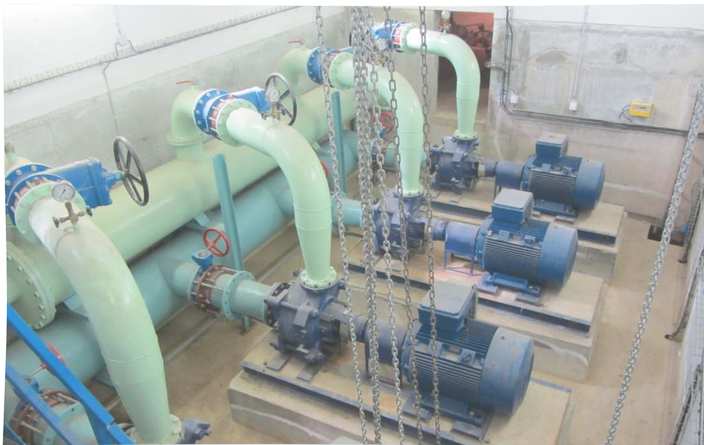
Station de pompage de Peyreras à l'Isle-sur-la-Sorgue
