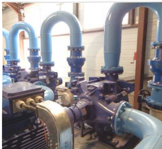
Station de pompage « La Masque » © Canal de Carpentras
