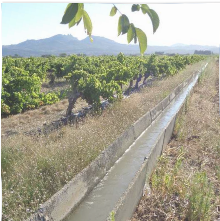
Filiole gravitaire sur le canal de Carpentras. © Canal de Carpentras
