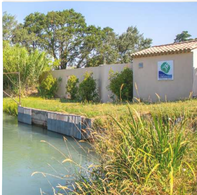
Station de pompage du canal de Cabedan Neuf prélevant l'eau dans le canal de l'Union. © Canal de Cabedan Neuf
