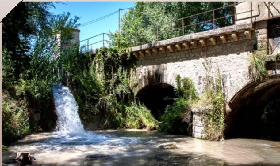
Déversement de l'eau du canal de Carpentras dans la Nesque pour régulation de son débit.
